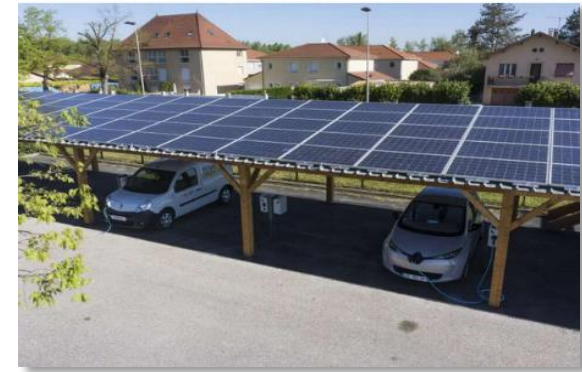
Parc au sol
